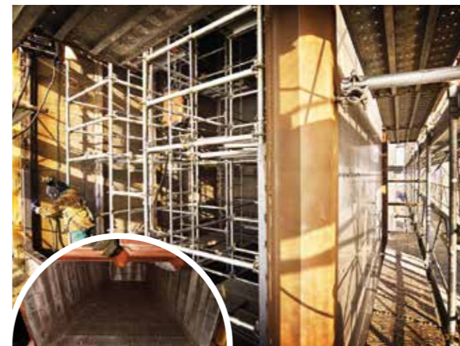
Demolizione e costruzione in opera di una batteria di sili metallici adibiti allo stoccaggio di alimenti zootecnici
