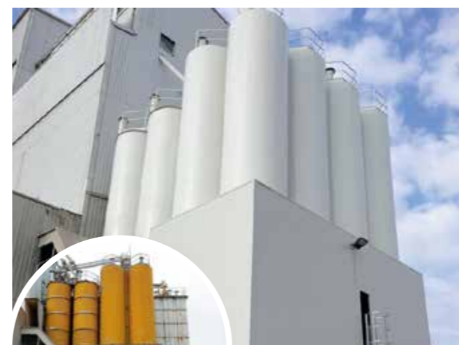
Riquilificazione, trattamenti protettivi e realizzazione nuovi tamponamenti di un gruppo sili prodotto finito
