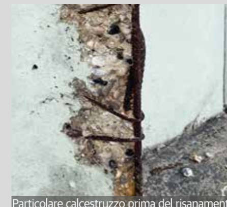
Particolare calcestruzzo prima del risanamento
