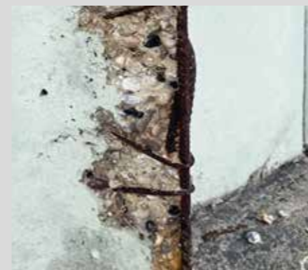
Particolare calcestruzzo prima del risanamento
