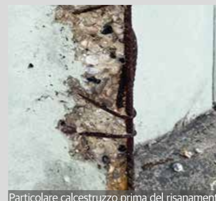
Particolare calcestruzzo prima del risanamento
