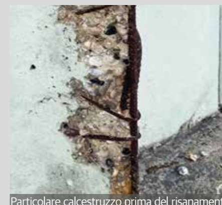
Particolare calcestruzzo prima del risanamento
