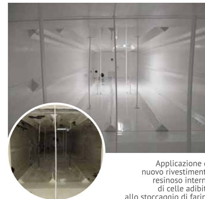
Riqualificazione, trattamenti protettivi e realizzazione nuovi tamponamenti di un gruppo silo prodotto finito
