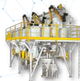
IMPIANTO DOSAGGIO INTEGRATORI
